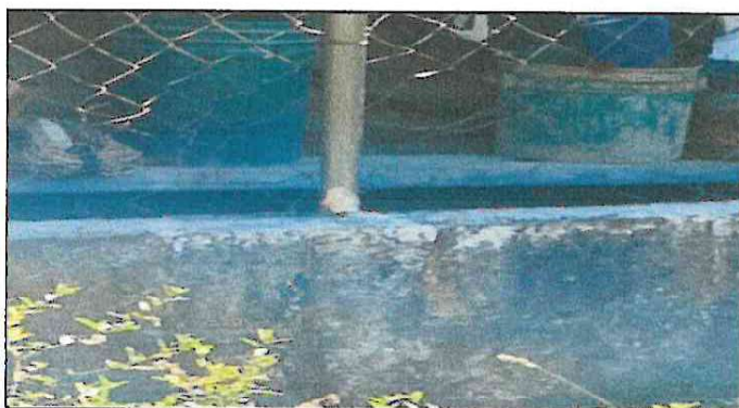
Foto 3: Malla y muro perimetral en mal estado
