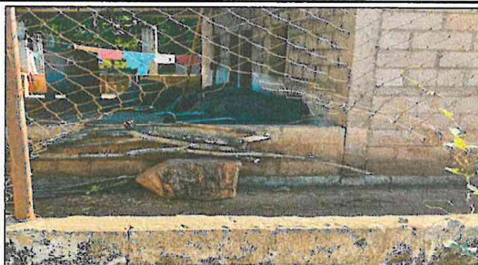
Foto 2: Malla y muro perimetral en mal estado
