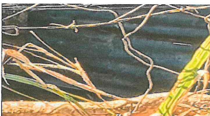
Foto 4: Malla en mal estado
