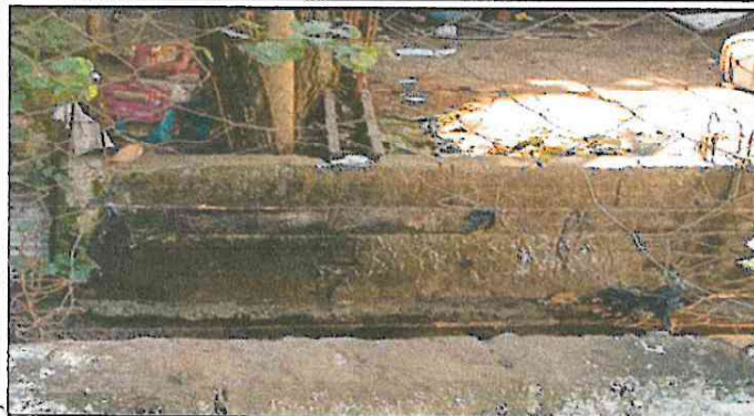
Foto 1: Muro Perimetral en mal estado
